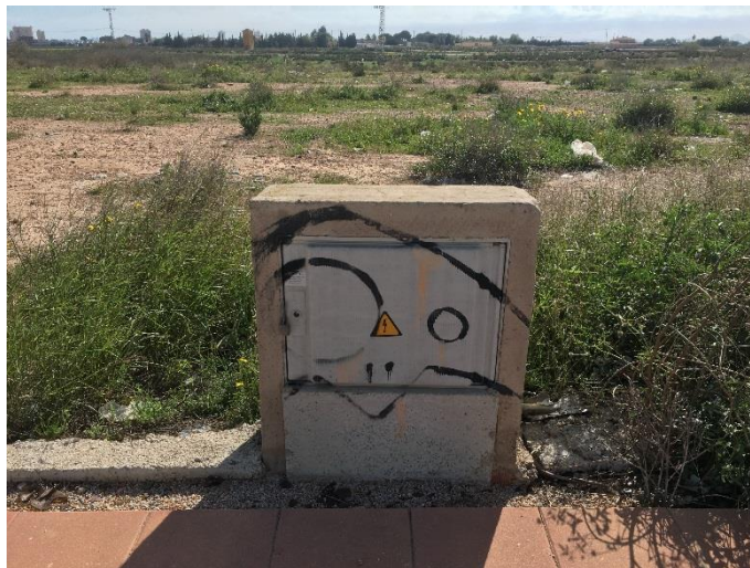
Armarios para la acometida eléctrica.
