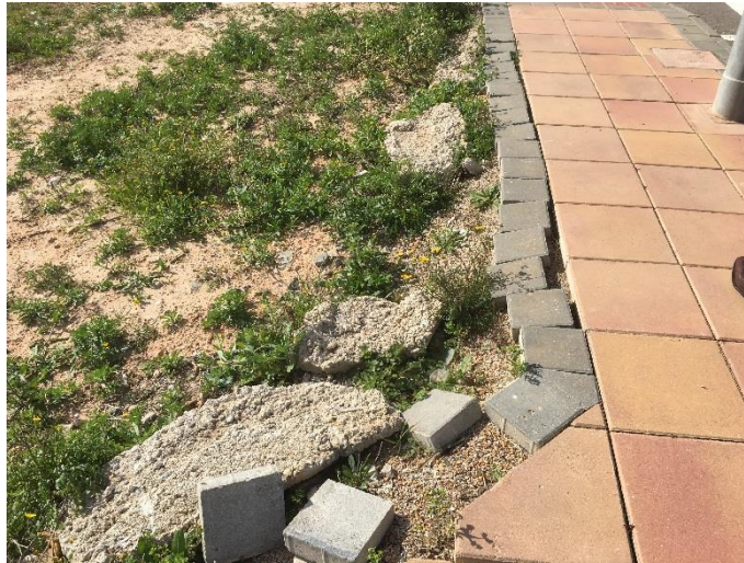
Estado del pavimento en algunas zonas del perímetro de la actuación.
