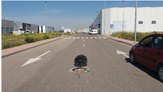
Pozo de saneamiento donde se acometerá red proyectada.
